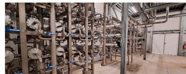
Figuur 3: foto vergistingsinstallatie Bio Blue Ieper
