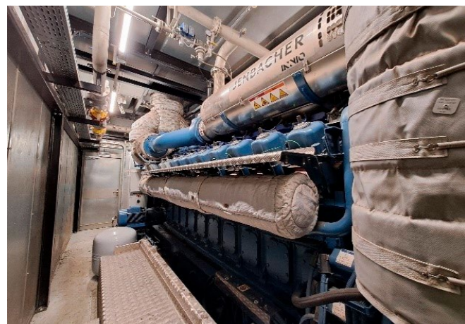
Figuur 6: foto vergistingsinstallatie Bio Blue Ieper
