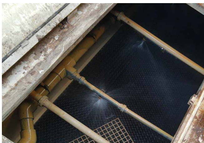
Chemische luchtwasser bij Biogas Bree
