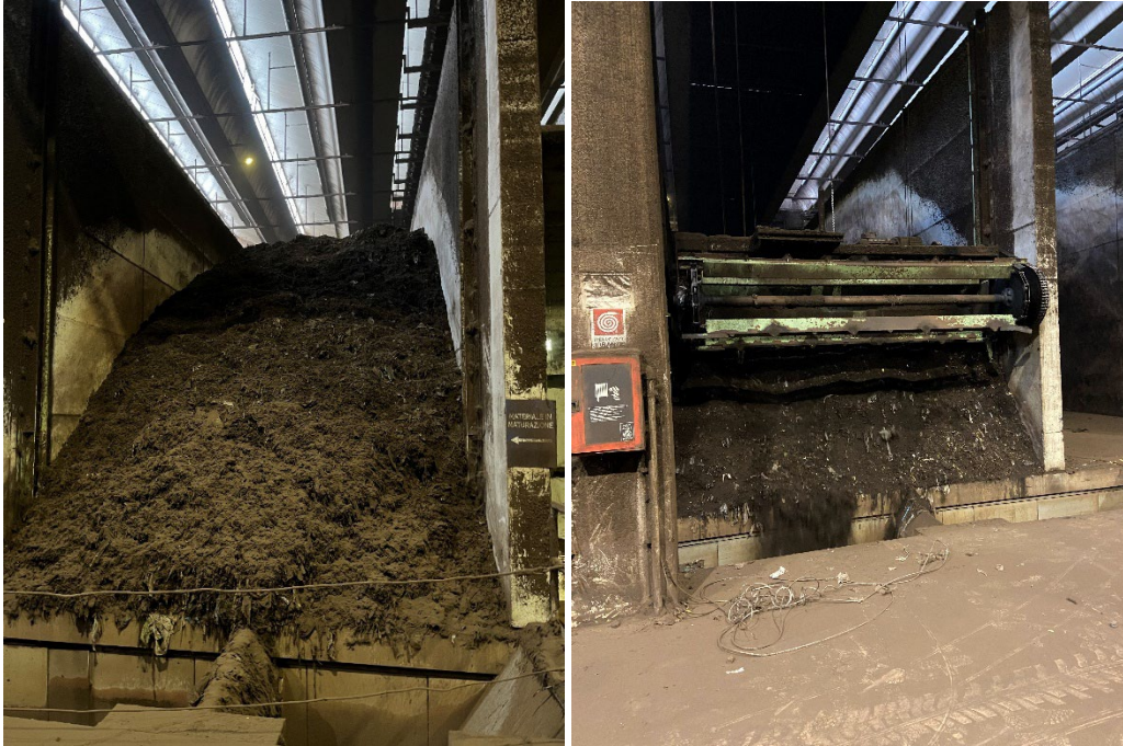
Figuur 103: De tweede composteersfase gebeurt in open tunnels die automatisch gevuld en geleegd worden.
