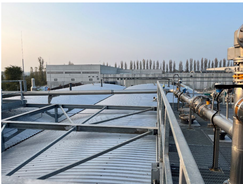
Figuur 91: Contarina heeft 2 liggende droge thermofiele vergisters.
